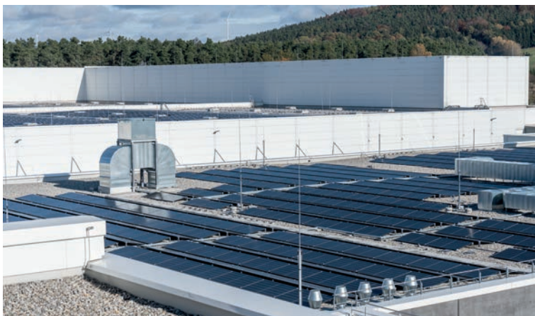
► Protection d'une installation photovoltaïque sur toiture.
